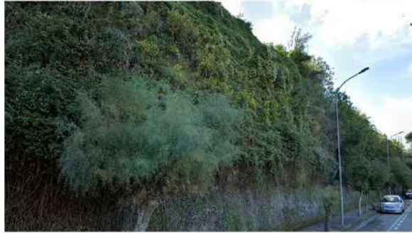
Scarpate in terreni detritici delimitanti superfici terrazzate
